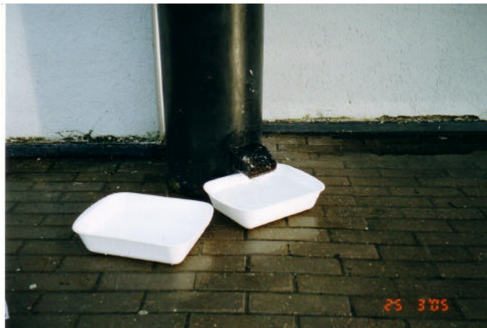
Joonis 32. Äravoolu mõõtmine võrdluskatusest.
