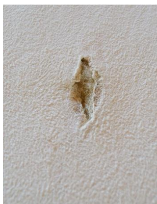
Vigastus pargitud nahal
