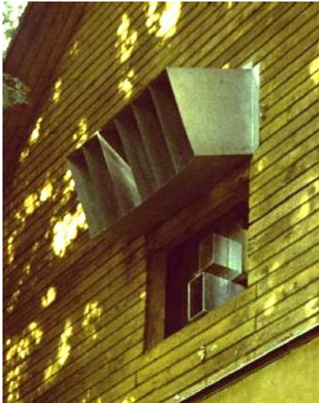
Tahkuse observatoorium: Õhu sisseimemisava (ülal) ja väljapuhumisava (selle all) pööningu otsaseinas. Lõplik konstruktsioon. Ringleva õhu kulu on 16.3 liitrit sekundis.
