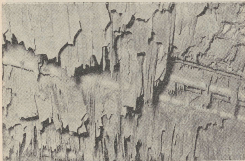
Рис. 4—7. Связанные отложения золы сланца-кукерсита на входе в первый по ходу газов пакет водяного экономайзера котла высокого давления, образовавшиеся при температуре газов около 700^{\circ}\text{C} . (Поток газов восходящий).
