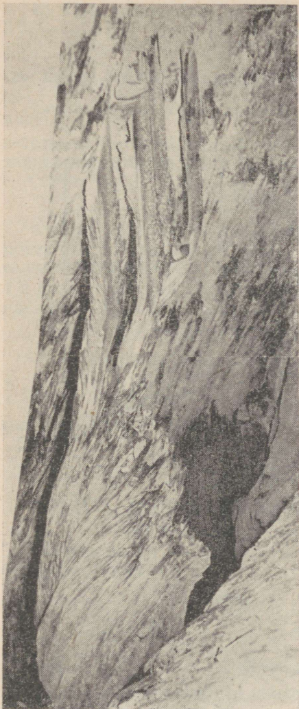
Рис. 8—6. Вид на косо оmyаемый участок опытных труб на входе в газоход после 790 ч работы без применения обдувки.
