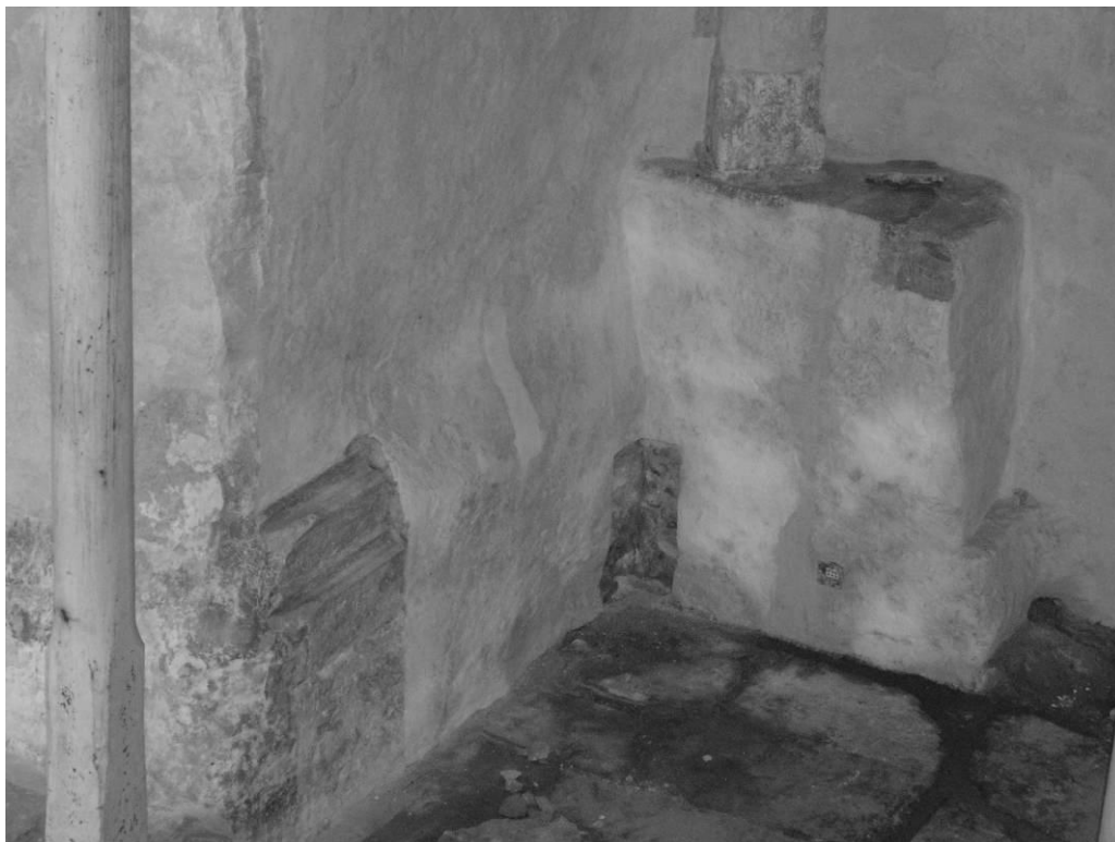
71. Pikihoone kagunurk algselt planeeritud pikihoone müüri fragmendi ja sellele toetuva võlvi eendtoega. Esiplaanil profileeritud soklikivi.
