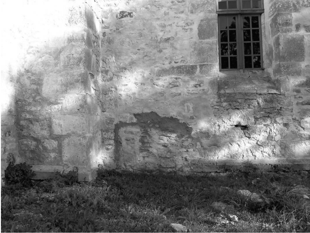
10. Koori lõunaportaali ehitusel purustatud sokkel..
