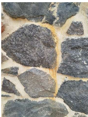
Foto 41. Tõenäoline kahjustus: rauaühendite oksüdeerumine ja soolade väljakristalliseerumine Lepiku, Tartu mk. 06.03.2025. Tiina Angerjärve foto.
