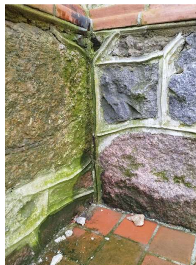
Foto 42. Niiskuskahjustus Tartu Jaani kiriku vundamendil 19.04.2025. Tiina Angerjärve foto.
