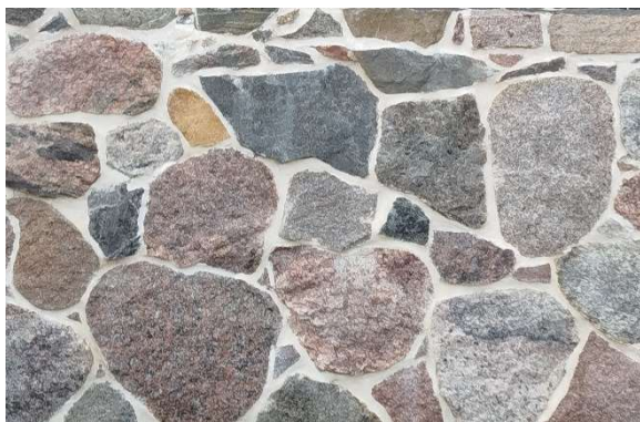
Foto 3. Ebakorrapäraselt laotud lõhutud kivid, mis tekitavad kaootilise vuugimustri 2025. Tiina Angerjärve foto.
