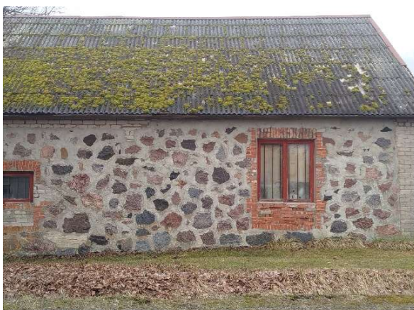
Foto 11. Pärnu-Tartu mnt.-l tsementmördiga ära rikutud kõrvahoone 01.03.2025.
