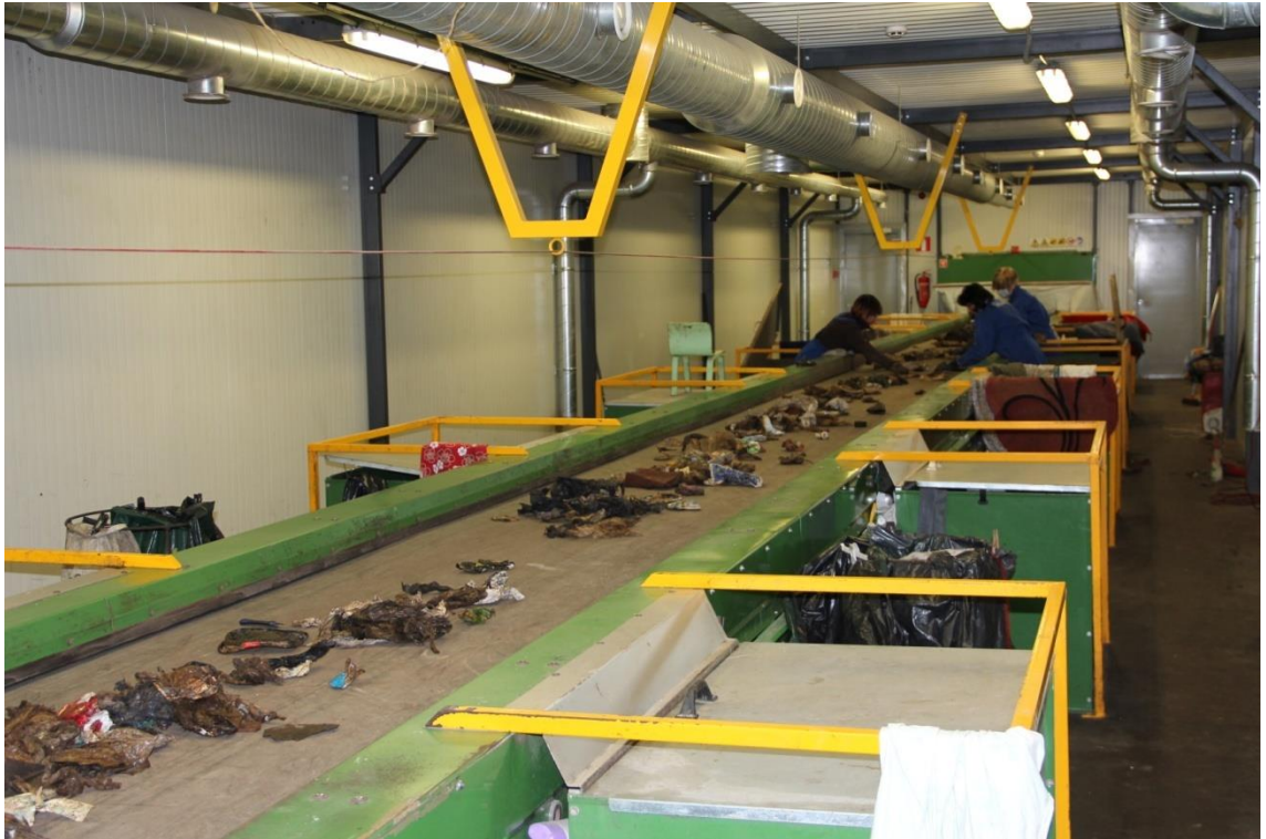
Joonis 16. Uikala prügila Jäätmekäitluskeskuse sortimisliin töö (autori foto, 2013).
