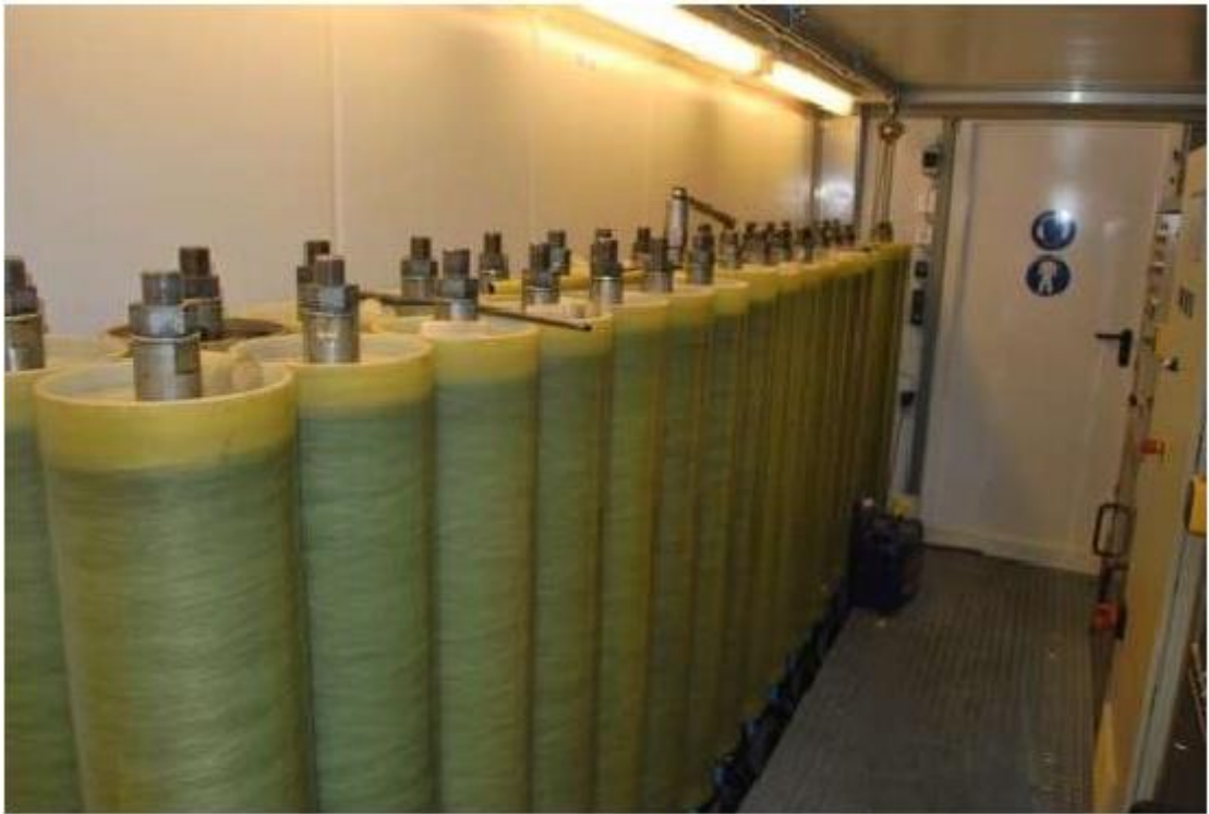
Joonis 20. Uikala prügila nõrgvee puhastamise pöördosmooseseadme filterelemendid (Loigu jt. foto, 2010).
