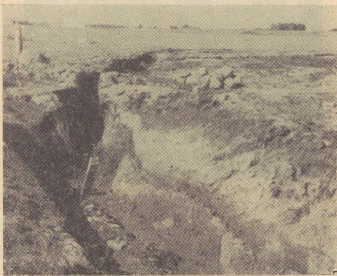
Joonis 14. Pinnavesi on purustanud drenisuudme.
