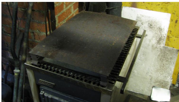
Foto 45. Soojuspeegeldina toimiv plekitahvel
