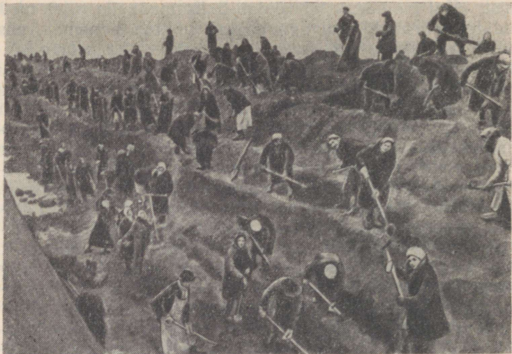
«Trjohgorka» töölised kaitseehituste rajamisel
