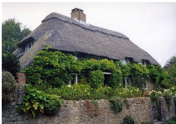
Joonis 16. Varajased katusekatte kulumise hoiatusmärgid - nähtavate kinnitusjoontega katus Essexis, Inglismaal.
