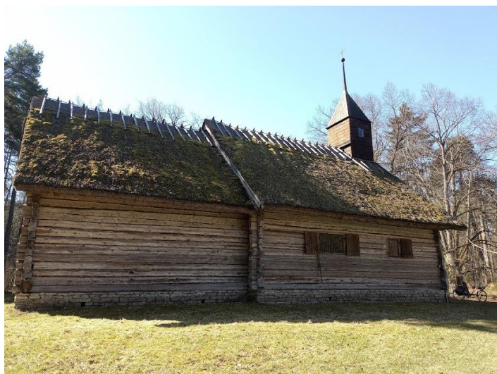
Joonis 31. Sutlepa kabel EVM. Sutlepa kabeli katust parandati 2020.aastal, ei enne ega pärast pole mingit hooldust tehtud. (Allikas: autori foto 23.04.2023)
