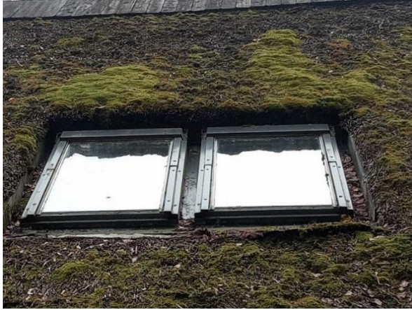
Joonis 41. Hoone põhjapoolse katuseosa katuseaknad. Autori foto.
