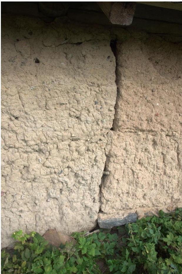
Foto 11 Läbiv pragu. Vundament on niiskuse poolt kahjustunud ja külmakergetega on tekkinud läbiv pragu, mis kajastub ka saviseinas. Jussi talu rehielamu. Foto autori erakogust. 2016
