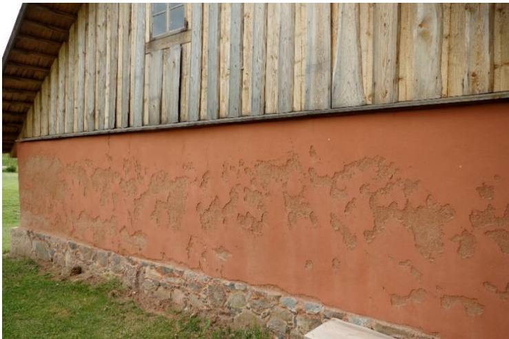
Foto 2 Rahepoolt lõhutud lubikrohv - lubikrohvi kiht õhuke. Lubikrohv toonitud punase saviga. Foto autori erakogust. 2016
