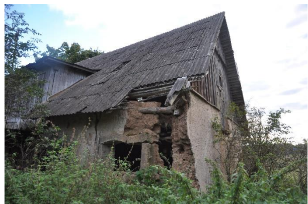
Laiialivajunud nurk ja varisemisohtlik aknasille. Otsa talu kuivati/laut. Foto: M. Tominga 2016.
