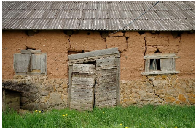
Vajunud uksetendrid ja murenenud savisille. Savilaut Põlvamaal. Foto: M. Tominga 2016.
