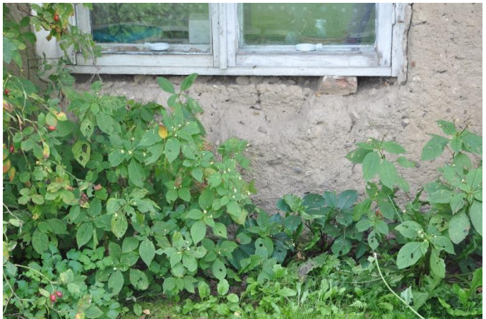
Puuduv akna veelaud ja tekkinud uhtekoht. Jussi talu rehielamu Tartumaal. Foto: M. Tominga 2016.
