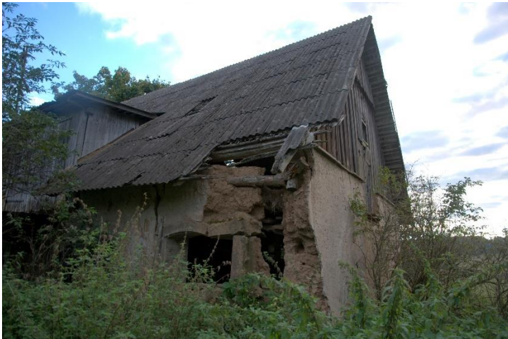
Foto 5 Uhtekohast tekkinud varinguoht. Otsa talu laut/kuivati. Foto autori erakogust. 2016
