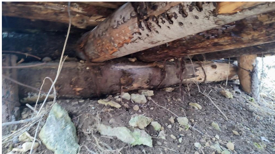
Joonis 31 Pinnaga kontaktis oleva konstruktsiooni vaade ja pindmised kahjud III (autori looming, 2025)
