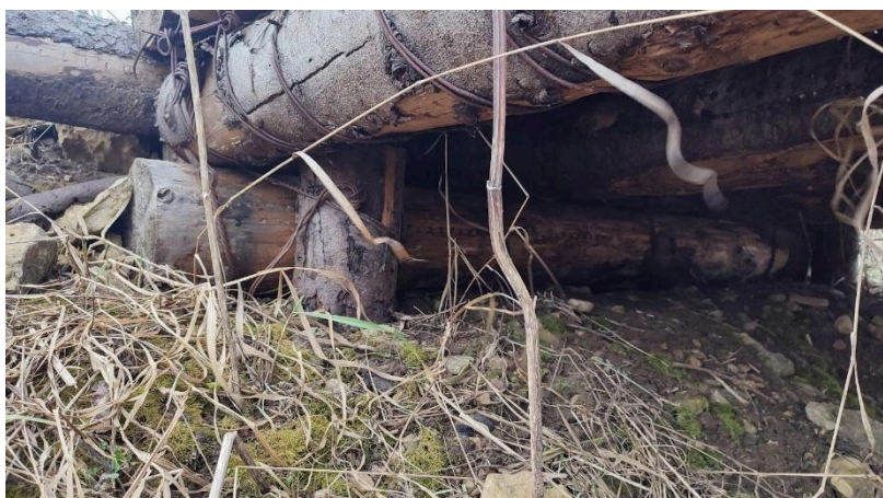
Joonis 26 Kaks aastat pinnasega kontaktis olnud vundamendi konstruktsioon (autori looming, 2025)
