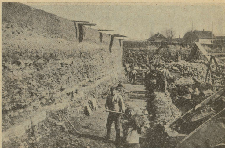
87. joon. Kohtla põlevkivi kaevandus. Peal 1\frac{1}{2} meetri paksune mulla ja kruusa kiht. Selle all tumedamad põlevkivi kihid, mis vahelduvad õhukeste heledamate lubjakivi kihtidega. Kaeviku sügavus on kohati üle 5 meetri. Põlevkivi tarvitatakse kõige rohkem raudteede ja vabrikute kütteks ning õli utmiseks.
