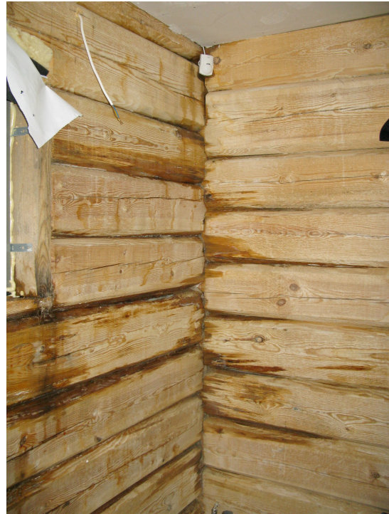
Foto 4. Avanenud tappidest voolab vesi konstruktsioonidesse
