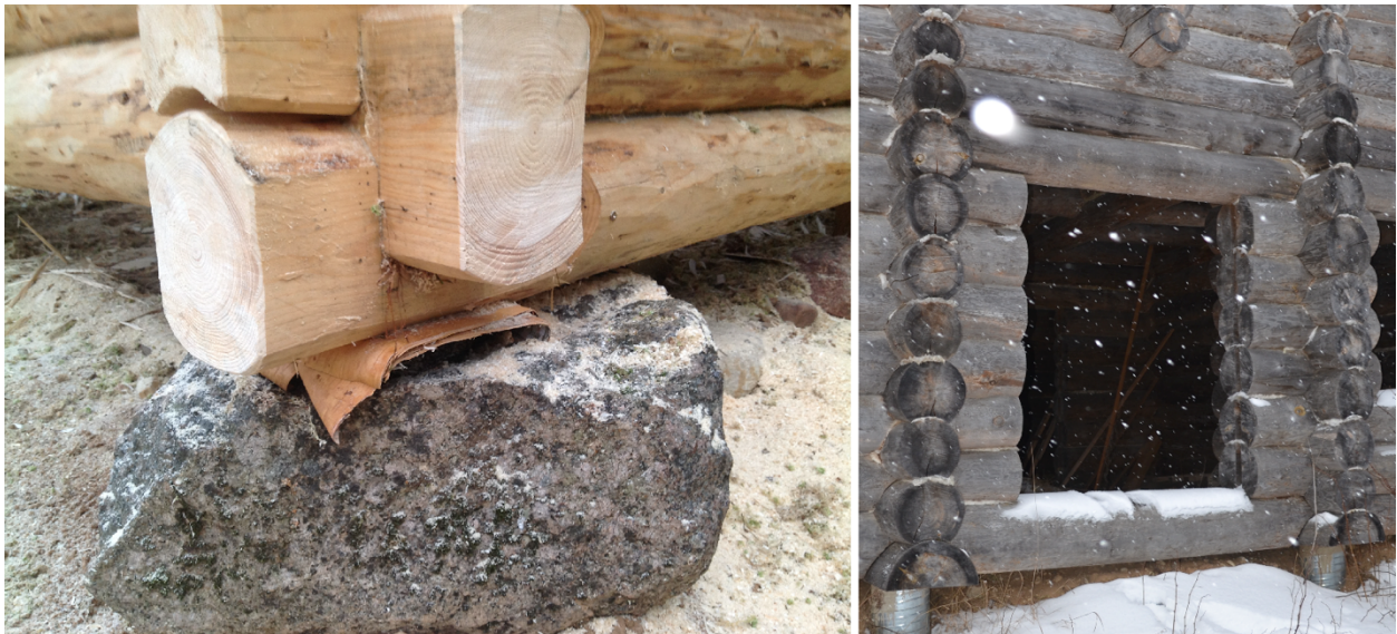
Joonis 38. Vasakpoolsel pildil - vaegvaramisega pähikud. Pähiku osas on vara avatud ning liigniiskus saab kergesti välja kuivada. Parempoolsel pildidil - vaegvaramiseta pähikud. Eriti kiire mädanemise kindlustamiseks on umbsed pähikuvarad isoleeritud klaasvillaga (foto: Andres Veel)
