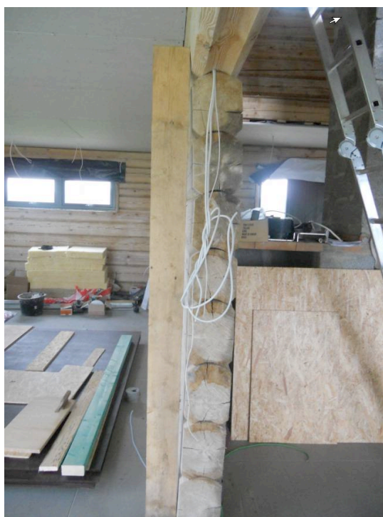
Foto 1. Esimese korruse vaheseina väljavajumine enne sirgestamist ca' 100mm (J-M Seavar'i foto).
