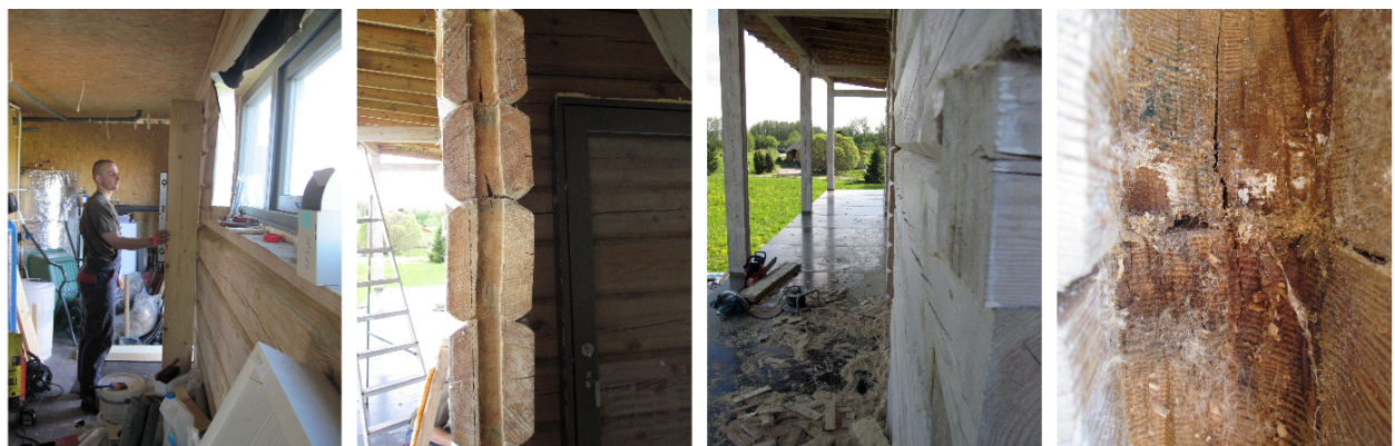
Joonis 57. Valed sõlmelahendused, ebapiisavalt dimensioneeritud materjal ning vastutustundetu töö teostamise kvaliteet on põhjustanud palkseinte väljavajumise, palkide keerdumise seinas ning bioloogiliste kahustuste tekke (Foto: Andres Veel)
