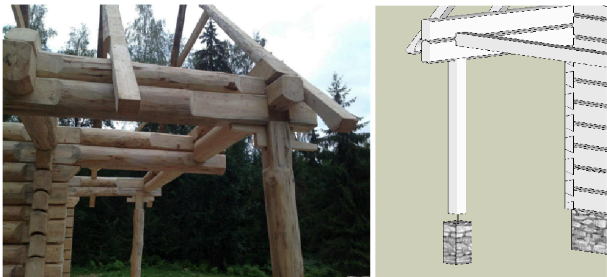
Joonis 64. Palkseina vajumine võimaldatakse kas kiilude või reguleeritava metalltoega (Joonis: Andres Veel)
