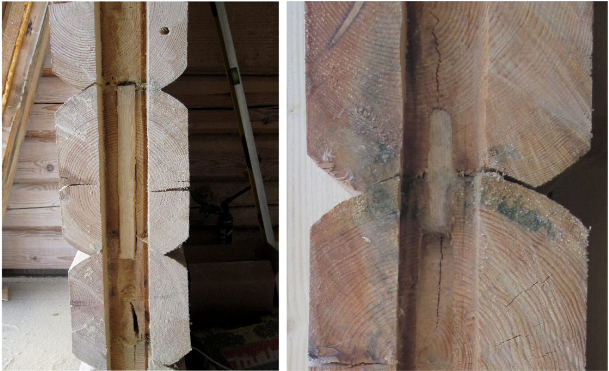
Joonis 51. Saulepa palkhoone. Oma funktsiooni mitte täitev salapulk. Salapulk ulatub siduvasse palki ainult 2cm ulatuses ning salapulga pesa on sattunud tenderposti liugtappi. Kuna sarnast olukorda võis näha mitmetes avade servades ning puudub ka ehitusdokumentatsioon mis vastupidist väidaks, võib eeldada, et selliselt on lahendatud salapulkade paigaldus kogu kahekorruselise hoone palkseina ulatuses (Foto: Andres Veel)
