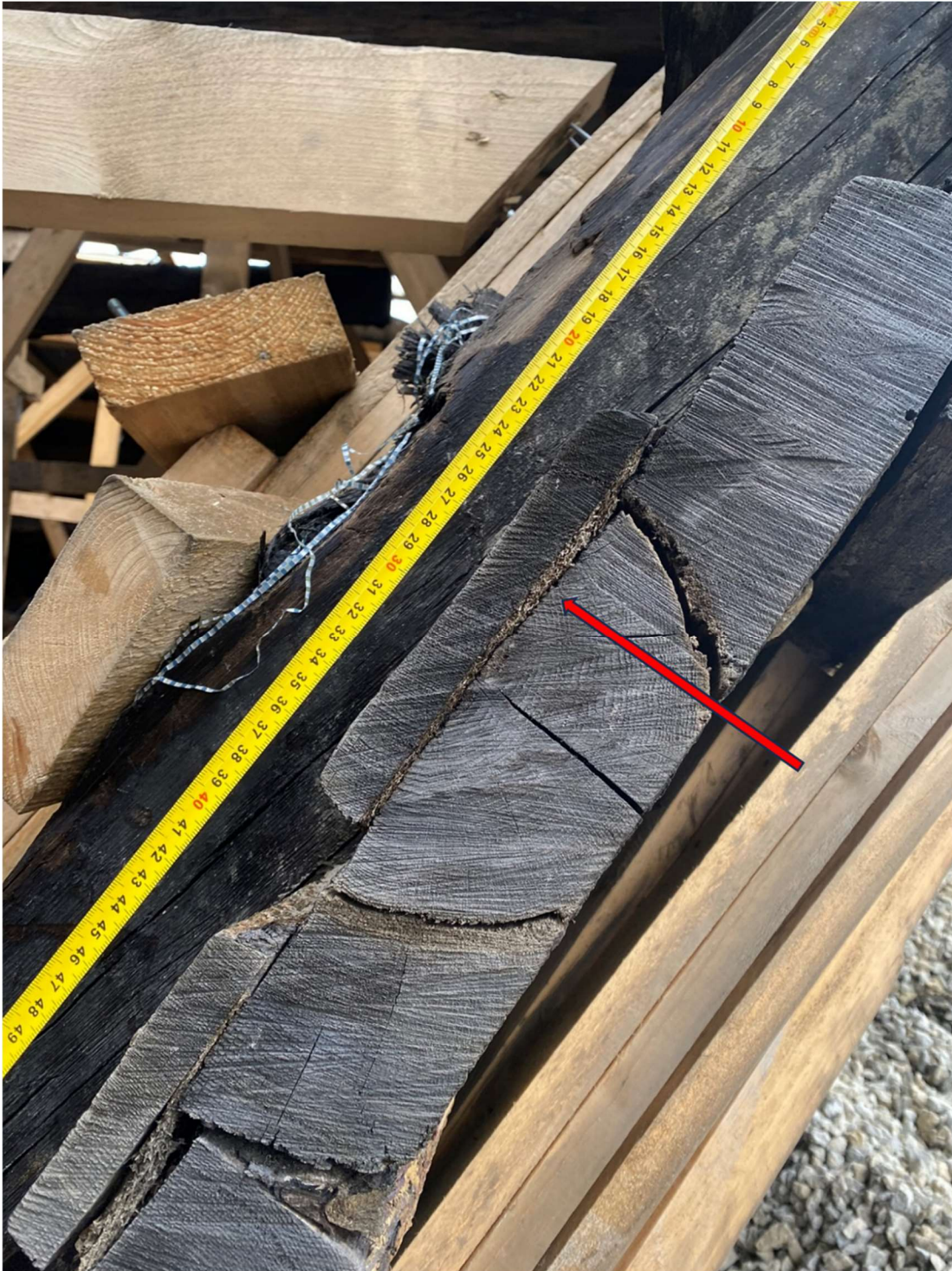
Lisa 4.4. Ehituse käigus lõhenenud põhjaplank laeva ahtriosas, millele on enne kaarte paigaldamist tugevdamiseks peale löödud õhem katteplank. Punasega on osundatud katte- ja põhjaplangu vahelisele õhukesele samblakihile.
