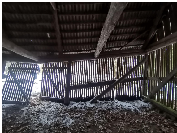
Joonis 8. Kuuri konstruktsioon ning purunenud tala.
