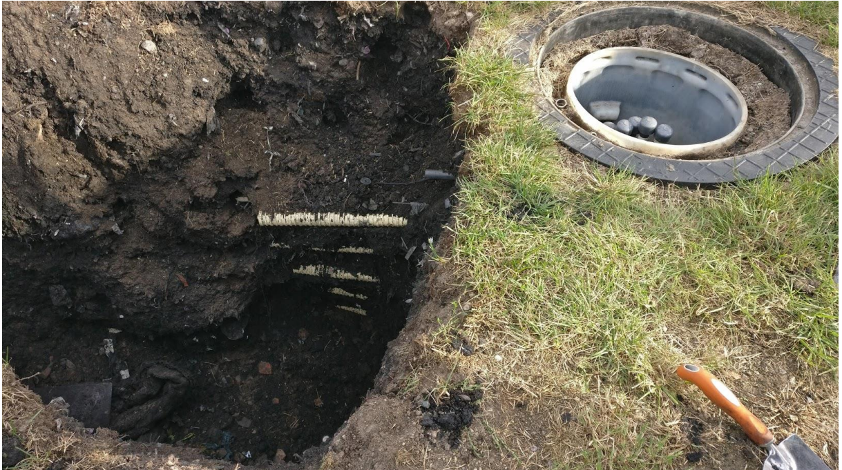
Joonis 1. Foto lahti kaevatud prügila metaanilagunduskattest. Pildil on näha statsionaarne gaasivõtukaev ning gaasikogumistorud pinnases
