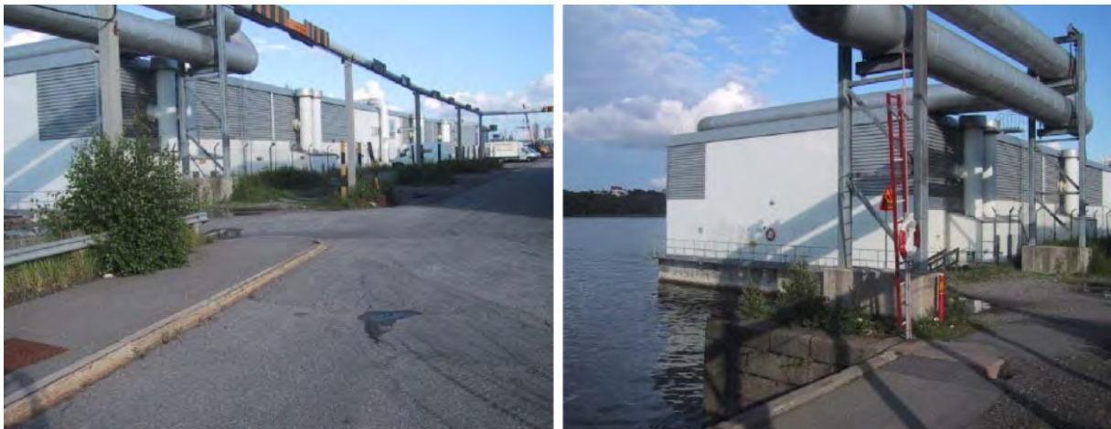
Joonis 3. Ropsteni kaugkütte ja -jahutusjaam (Nowacki, 2014).
