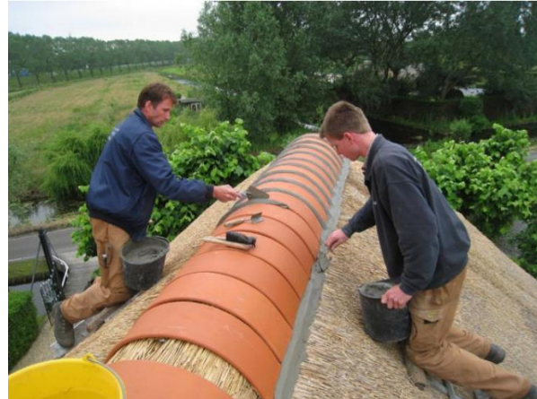
Foto 18 Harjakivid laotakse lubjarohke mördiga, vuugi stiil oleneb paikkondlikest eripäradest, mõnel pool täidetakse tasa, teisel pool jäetakse vuuk paksem ja väljaulatuv. (Vakfederatie Rietdekkers, 2023a)
