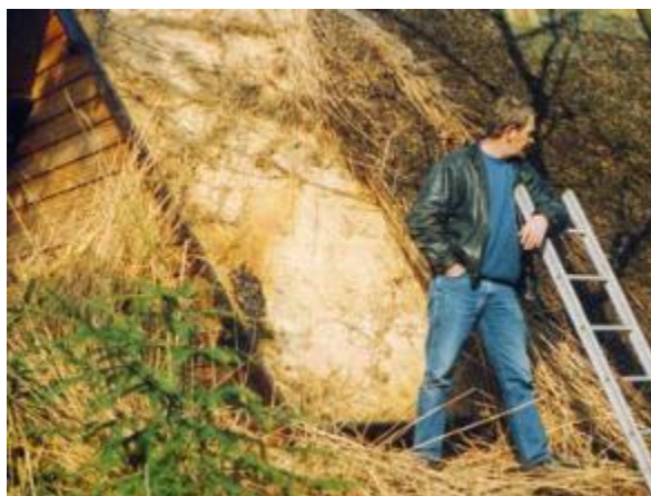
Foto 4 Süttinud ja ise kustunud kinnise konstruktsiooniga garaaži katus (Vakfederatie Rietdekkers, 2004)
