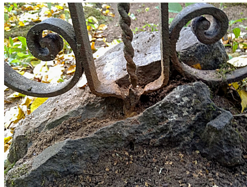
Joonis 28. Sepisristi kinnitus ja korrodeerunud raami osad kinnituskivi juures (autori foto)
