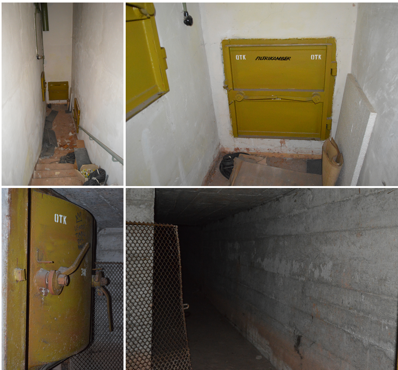
122–125. Trepp evakuatsioonipääsu juurde, filtrikambri luuk, analoogne luuk evakuatsioonitunneli ees ning tunnel ise.
