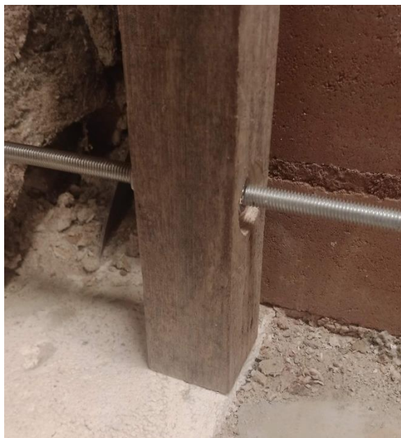
Foto 10 Raketise tugipost on looditud ja fikseeritud keermelati külge mutrite ning seibide abil – välipinna kaugus seinast järgib EPS soojustuse piiri
